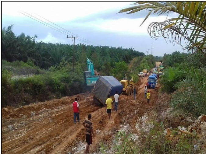
Kondisi Sta.48+300 (Rusak Akhir 2016)
